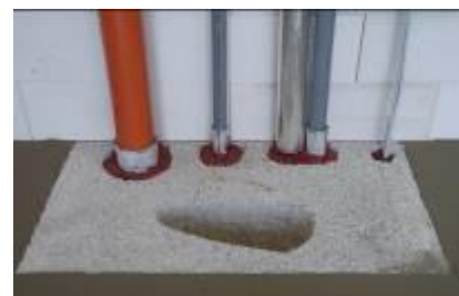
Installationsblock mit Abschottungen
